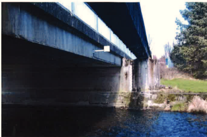
Umístění čidla vodní hladiny na přítokové hraně mostu přes Lužickou Nisu v Liberci Machníně
