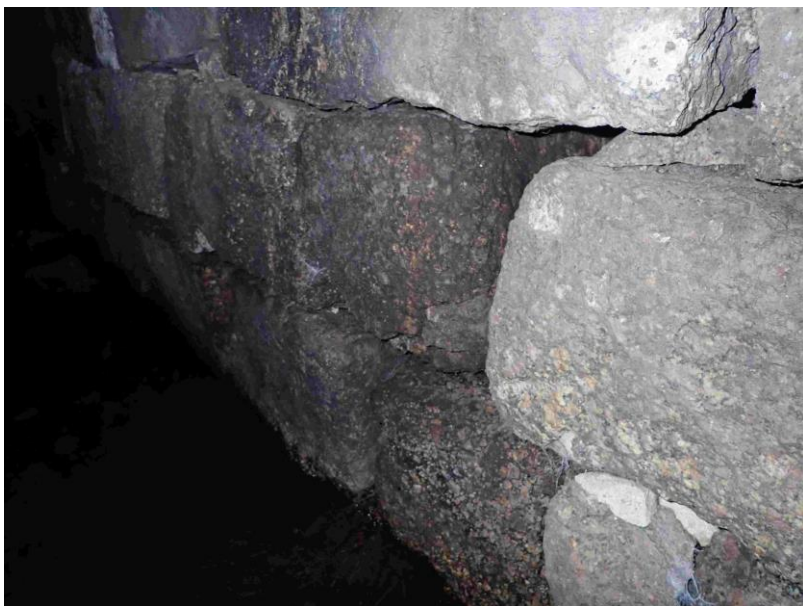
Deformace zdiva opěry, vymleté spárování
